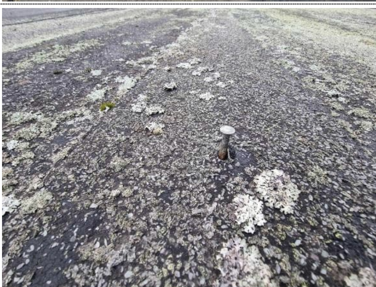
Bilde 152: B-661 Oppstikkende spiker gjennom tekking på tak over basseng
