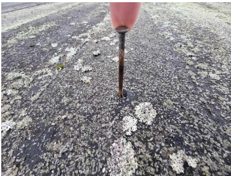
Bilde 153: B-662 Løs oppstikkende spiker gjennom tekking på tak over basseng
