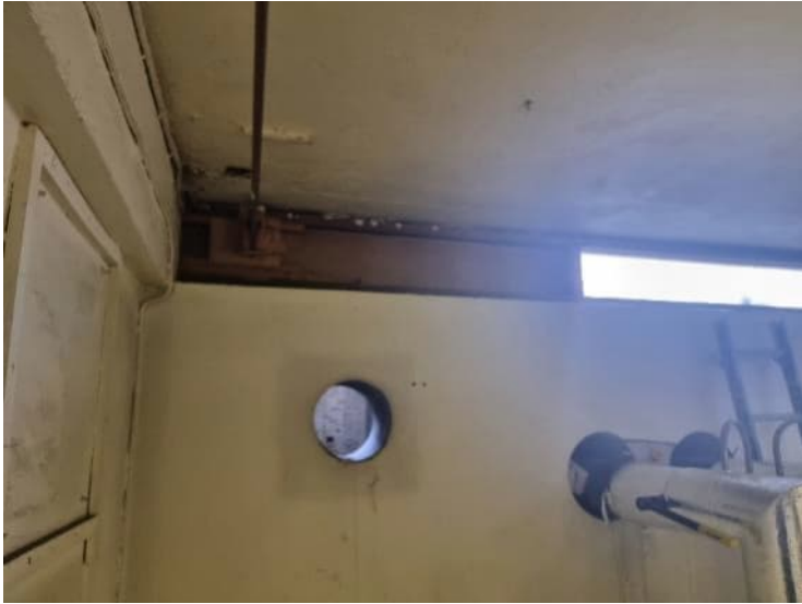
Bilde 37: B-973 Åpning i vegg fyrrom
