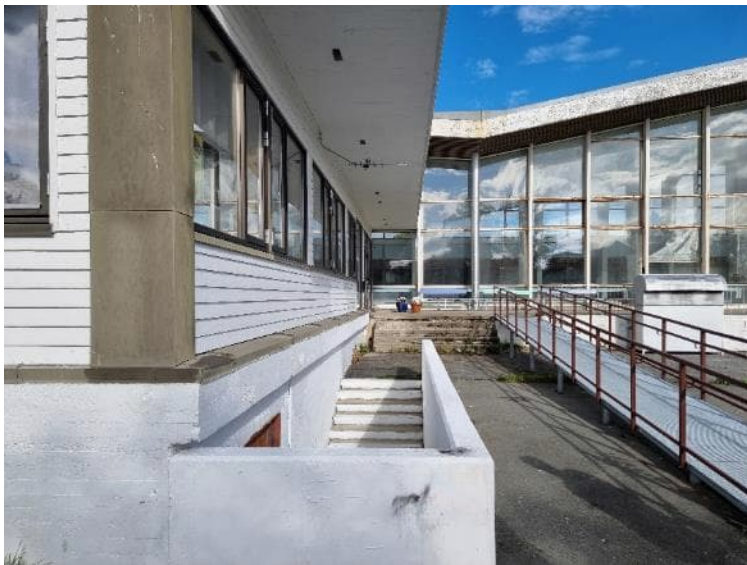
Bilde 180: B-574 Skadet utvendig trapp til utvendig balkong
