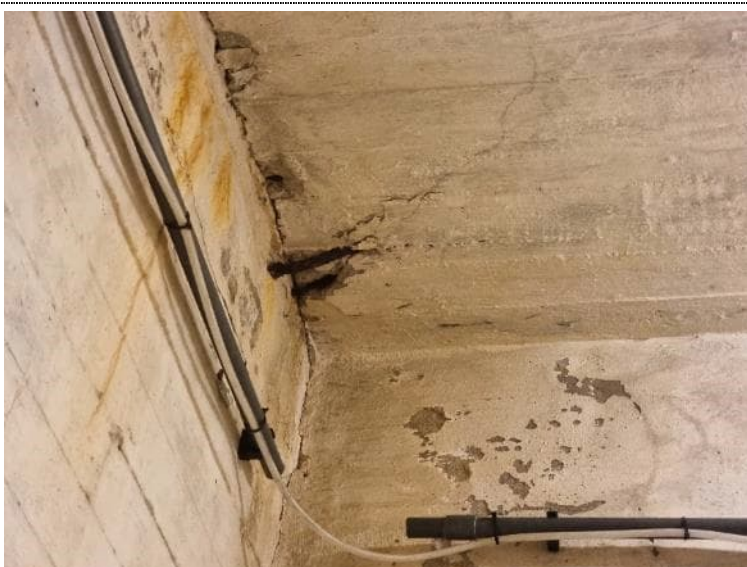
Bilde 85: B-149 Synlig korrodert armering uk dekke over plan U
