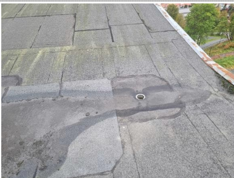
Bilde 161: B-656 Manglende rist på taknedløp over basseng.
