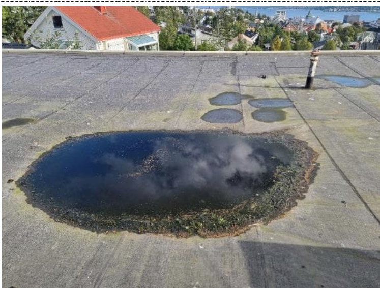
Bilde 151: B-036 Stående vann flere områder på tak.
