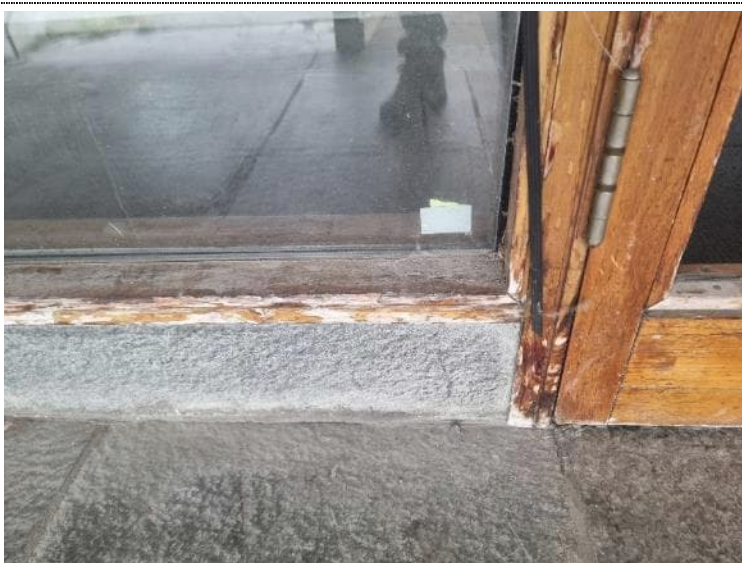
Bilde 54: B-731 Løse pakninger i glassfelt ved hovedinngang
