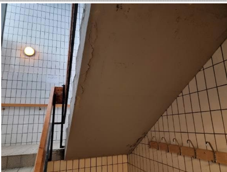
Bilde 170: B-371 Betongskader på innvendig trapp fra plan 0 til basseng.
