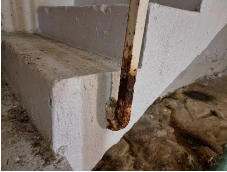
Bilde 186: B-094 Korrosjonskadet rekkverks- innfesting trapp plan U
