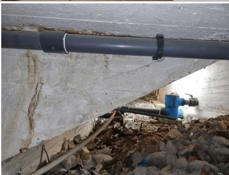
Bilde 88: B-157 Riss sidekant bassengdekke
