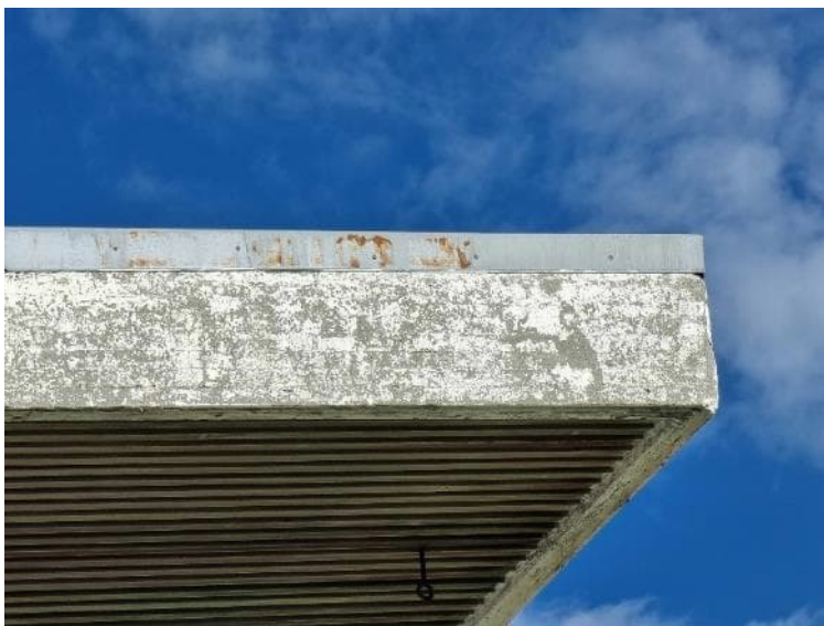
Bilde 144: B-580 Slitte overflater på sidekanter av betong
