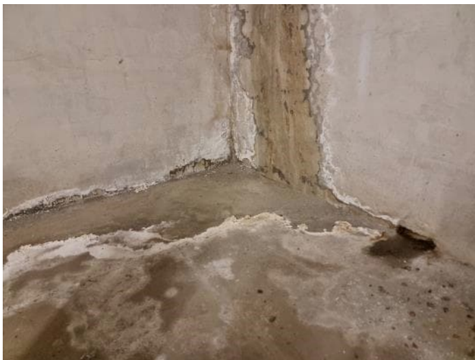
Bilde 11: B-230 Fukt i hjørne mot gulv i berederrom
