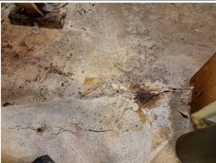
Bilde 95: B-127 Oppsprukket gulv på grunn plan U.
