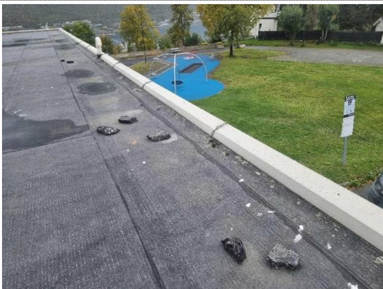
Bilde 157: B-626 Asfaltbiter på taket
