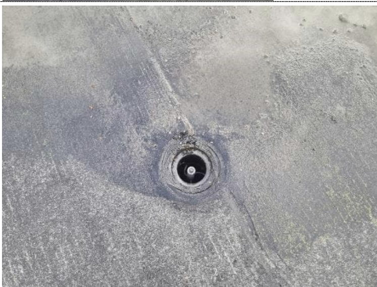
Bilde 160: B-630 Manglende rist på taknedløp
