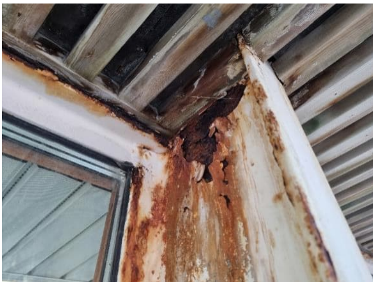
Bilde 43: B-023 Korrosjon på stålbering fasade
