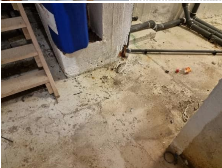
Bilde 29: B-124 Avskalling og armeringskorrosjon på betongsøyle nordøst plan U
