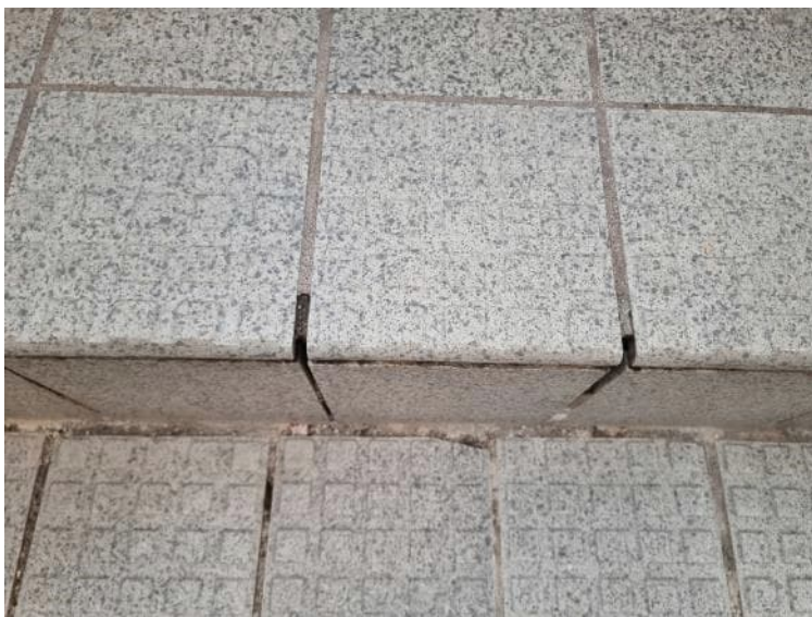
Bilde 174: B-396 Dårlige flisefuger i trapp
