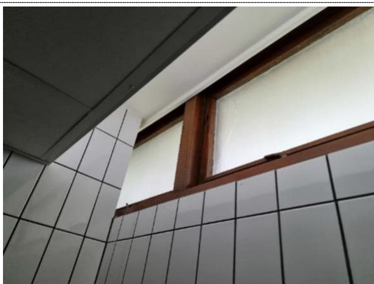
Bilde 51: B-491 Sprekk i glass mot nord
