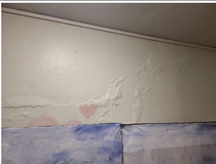
Bilde 12: B-063 Fuktskader i kjeller aktivitetshus
