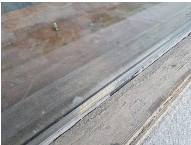
Bilde 52: B-552 Dårlige pakninger/fuger, mot vest
