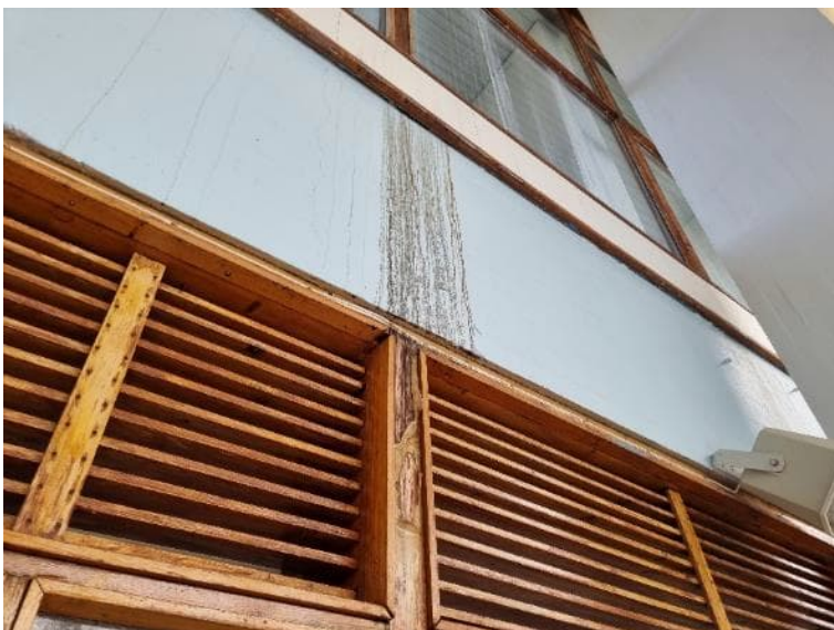
Bilde 77: B-499 Rennemerker fra lekkasje/kondensvann i bassengrom
