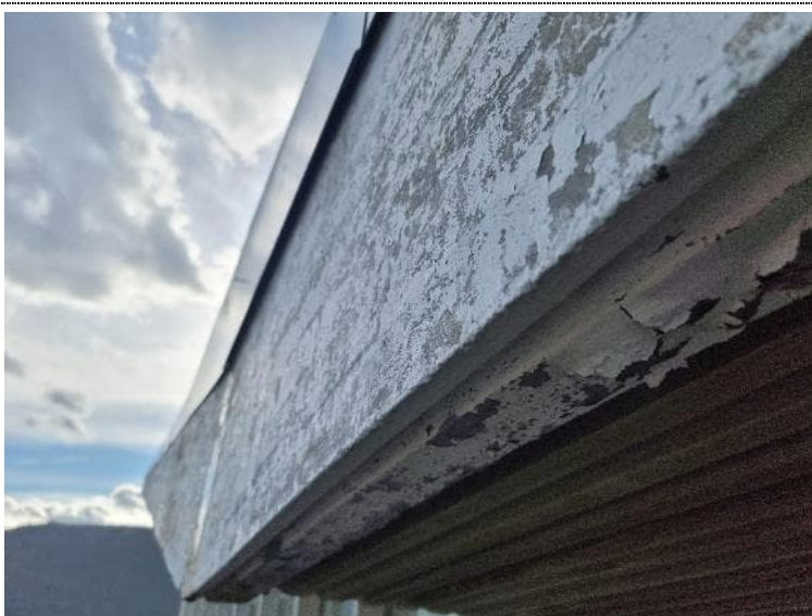
Bilde 145: B-032 Slitte overflater på sidekanter av betong
