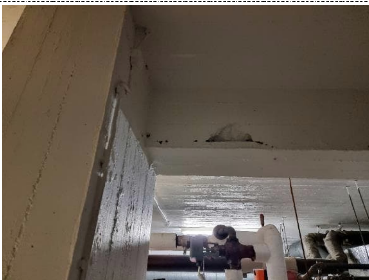
Bilde 30: B-340 Dårlig utstøpt bjelke i dopl. 0 under bassengrom.
