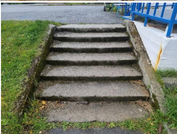
Bilde 178: B-690 Skadet utvendig trapp i terreng
