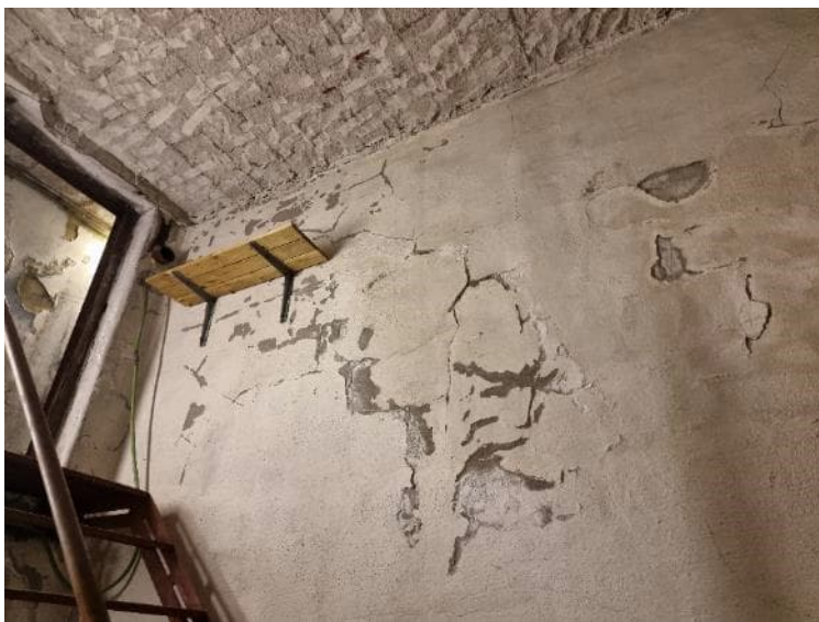
Bilde 9: B-224 Fuktskader i vegg mot øst
