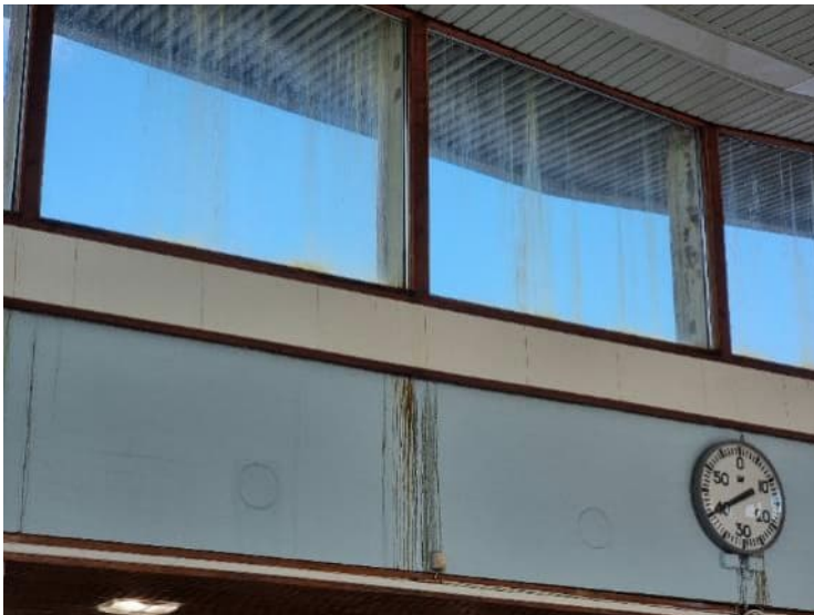
Bilde 38: B-005 Avrenning/lekkasje fra vindusfelt
