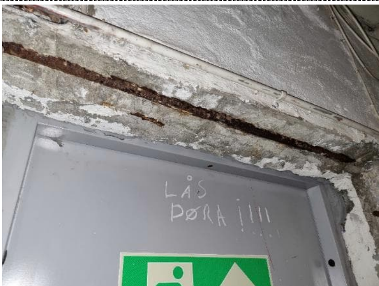
Bilde 33: B-283 Korrodert armering over døråpning plan 0 mot sør
