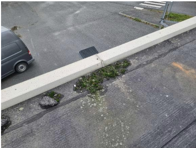
Bilde 156: B-624 Mosegrodd takoverflate med steiner/asfaltbiter på taket
