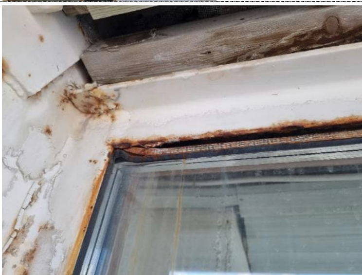
Bilde 45: B-029 Dårlig pakning glassfasade
