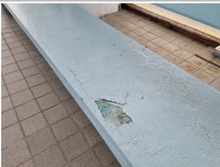
Bilde 169: B-529 Løs overflatebehandling på benker i bassengrom
