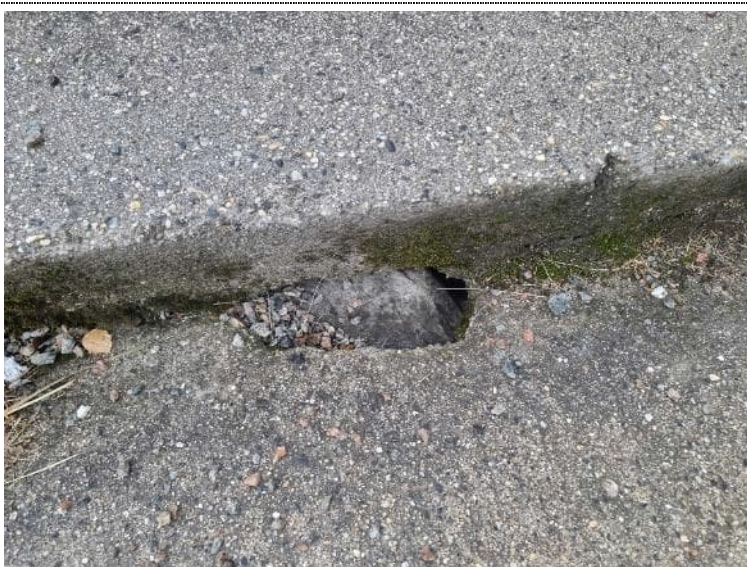
Bilde 179: B-691 Skadet utvendig trapp i terreng
