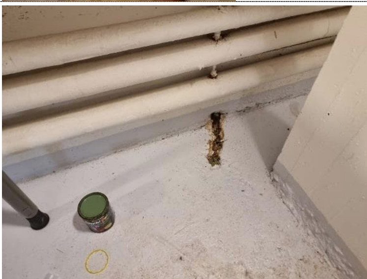
Bilde 103: B-308 Gulvoverflate plan 0 med armeringskorrosjon
