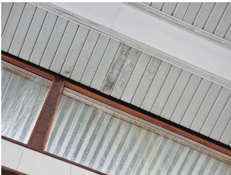
Bilde 168: B-693 Fukt- og korrosjonskader på Innvendig himling over basseng
