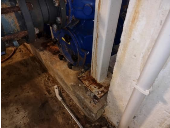
Bilde 25: B-201 Korrosjon på søylefot plan u
