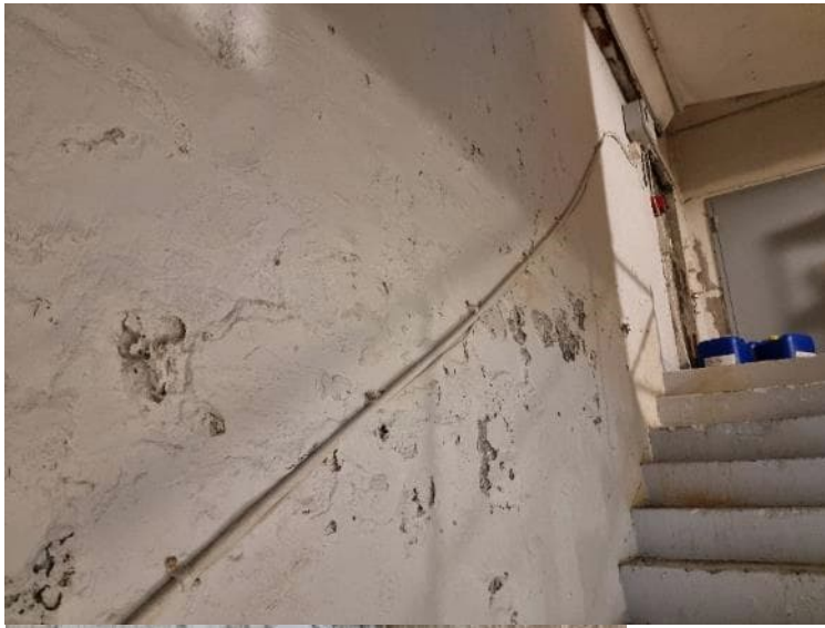
Bilde 4: B-096 Fuktskader sørvegg plan U
