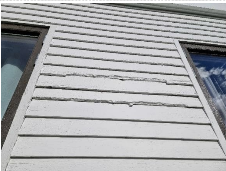
Bilde 65: B-571 Råteskade i trekledning mot sør
