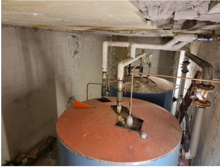
Bilde 7: B-222 Fuktskader i tak og vegger i berederrom
