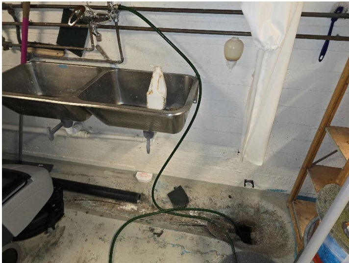
Bilde 13: V-446 Rør fra løfilter avsluttes for tidlig, burde vært ført til sluk.
