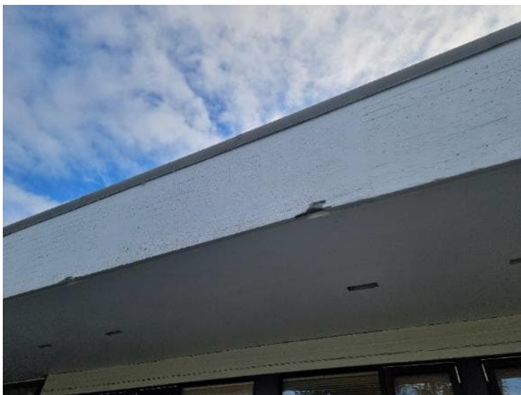
Bilde 150: B-993 Skader langs dryppnese med avskalling betong
