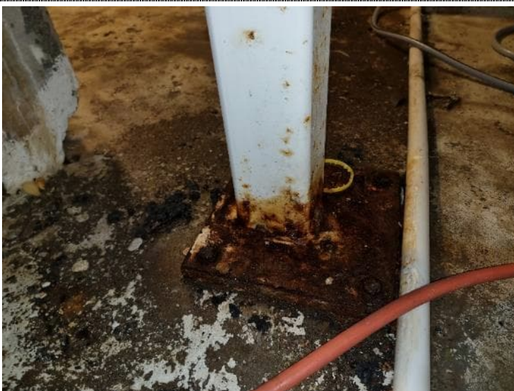
Bilde 27: B-213 Korrosjon på søylefot Plan U
